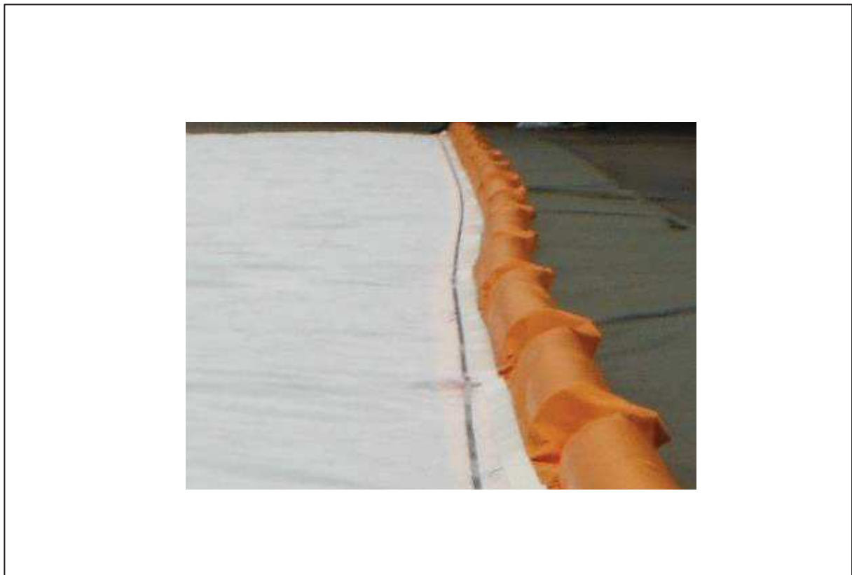
図 55-4-4 シルトフェンス 外観写真
