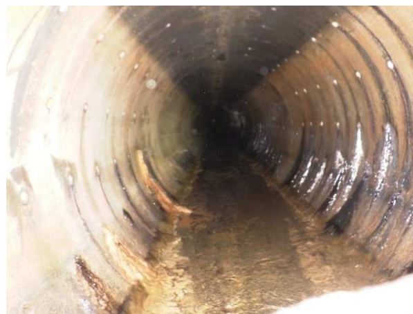
写真B ドレーン（有孔ヒューム管φ1,050mm） 2018/9/18撮影
