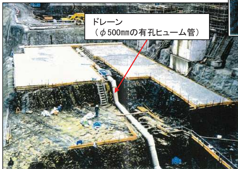
写真3-3 2号炉タービン建屋ドレーン( \phi 500\text{mm} の有孔ヒューム管)
