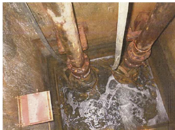
写真D 揚水井戸⑤（下段部） 2017/3/17撮影
