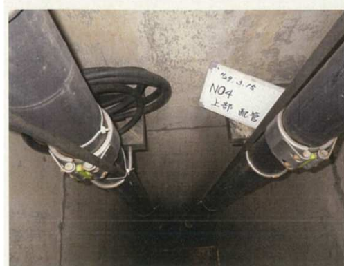
写真3-5 2号炉配管の例(揚水井戸④)
