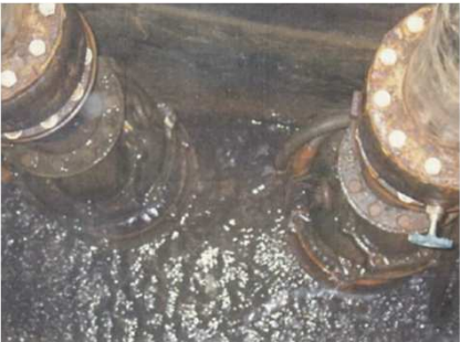
2号炉揚水ポンプの例(揚水井戸⑥) 3号炉水位計の例(揚水井戸⑦)
