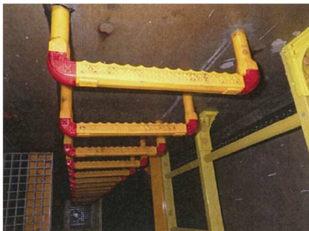
写真C 揚水井戸⑤（中段部） 2017/3/17撮影
