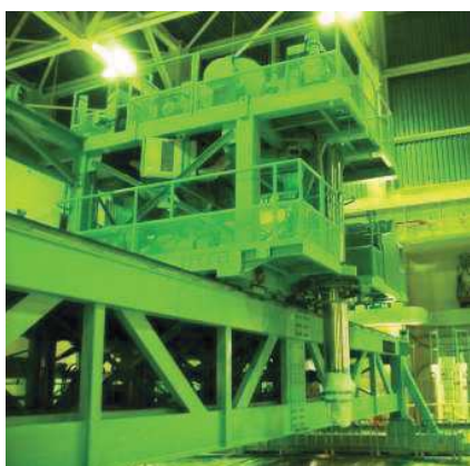
燃料交換機（トロリ）外観
