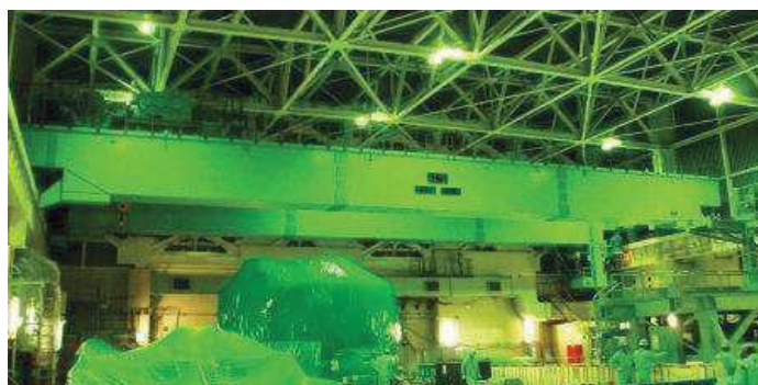
原子炉建屋クレーン外観
