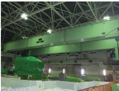
原子炉建屋クレーン
