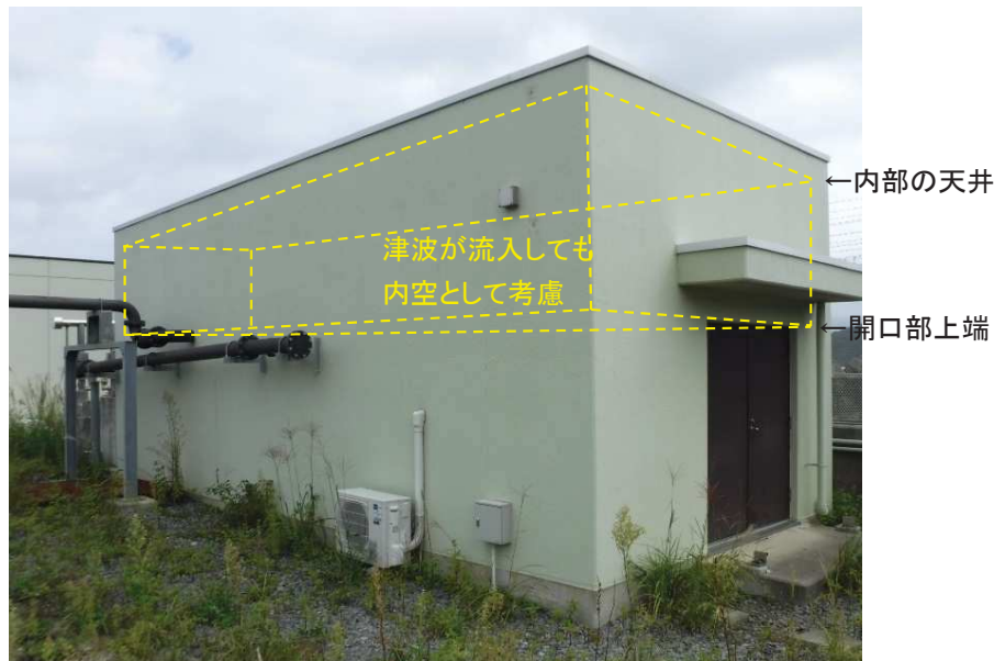
建物に津波が流入しても考慮する空間 (2号炉放流管真空ポンプ室の例)
