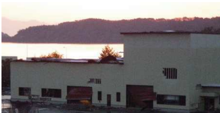
建屋壁材の剥がれ状況
