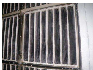
(バグフィルタ入口側)
