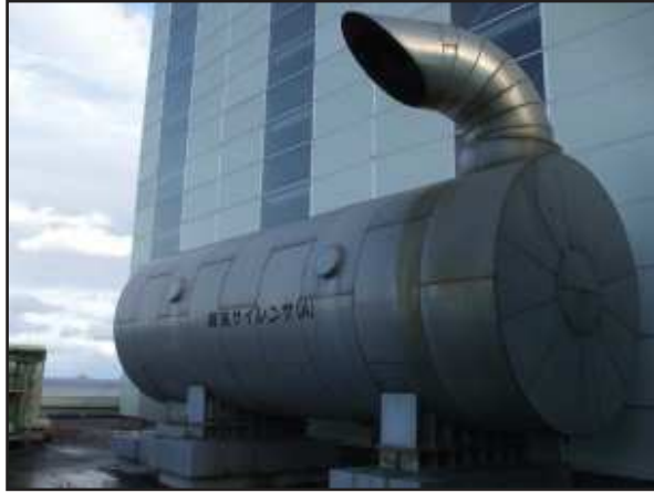
図3 非常用ディーゼル発電機排気消音器及び排気管
