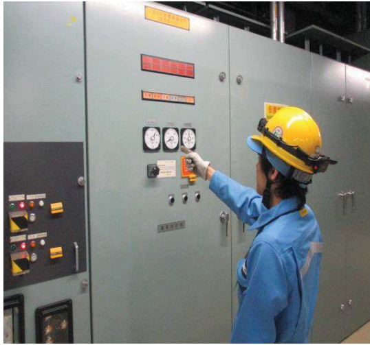
125V 代替充電器盤の受電状態確認
