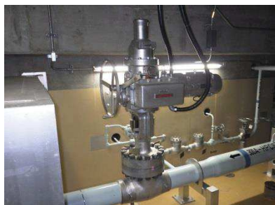
HPCS 注入隔離弁
