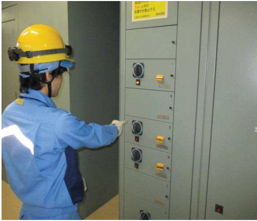
MCC 負荷の切離し操作
