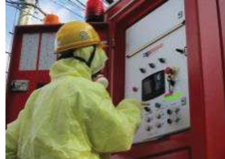
大容量送水ポンプ（タイプ I）の起動
