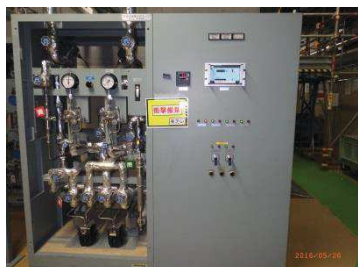
格納容器露点計ラック
