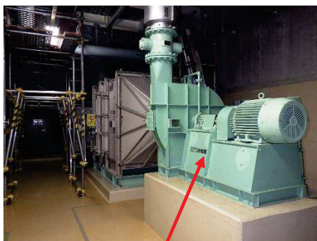
非常用ガス処理系排風機
