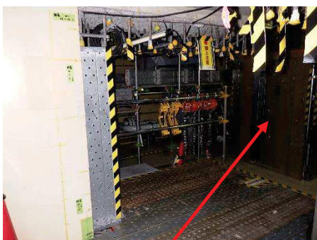
ポンプ (設置予定場所)
