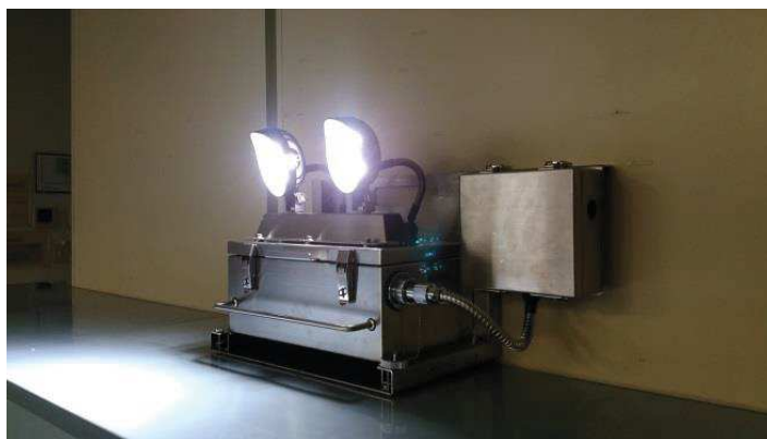
第41-1-26図：消火用非常用照明の設置例
