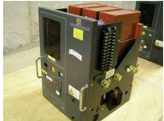
パワーセンタ 種類：気中遮断器
