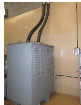
オペフロ電源 ボックス用変圧器
