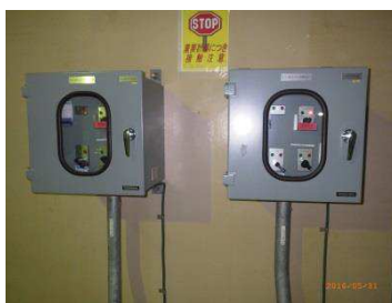
ほう酸水注入系現場操作箱
