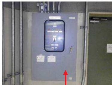
ハッチ開閉装置制御盤
