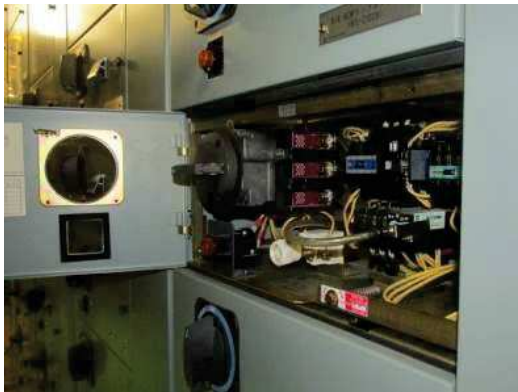
モータコントロールセンタ 種類：配線用遮断器
