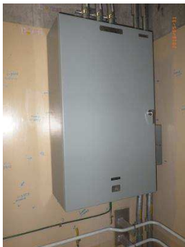
エリア放射線モニタ 多重伝送現場盤
