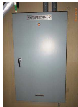
作業用分電盤
