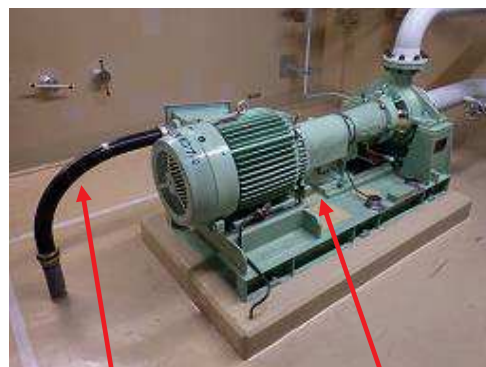
可とう電線管 ポンプ
