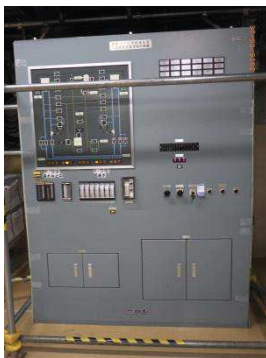
燃料プール冷却浄化系ろ過脱塩装置現場制御盤
