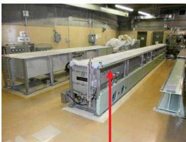
CRD 補修設備
