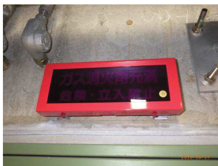
第 41-1-25 図：全域ガス消火設備の職員退避警報装置の例
