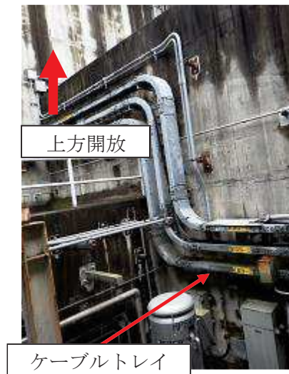
設置されている機器①
