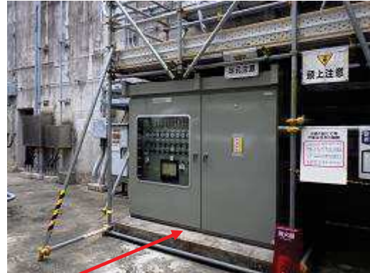
設置されている機器①
