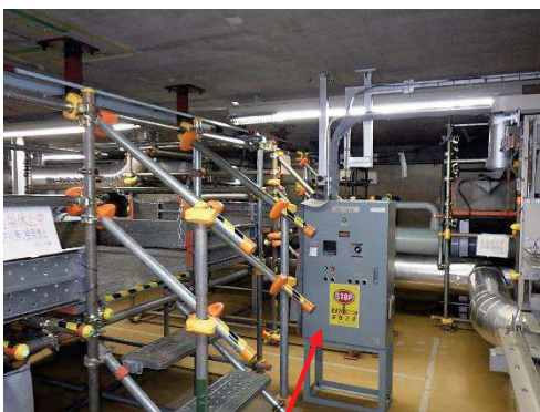
PLR サンプリング配管ヒータ制御盤
