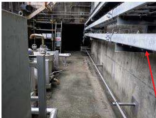
設置されている機器②
