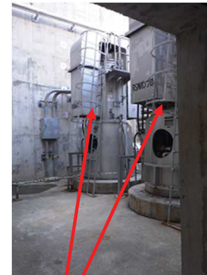
原子炉補機冷却海水ポンプ電動機
