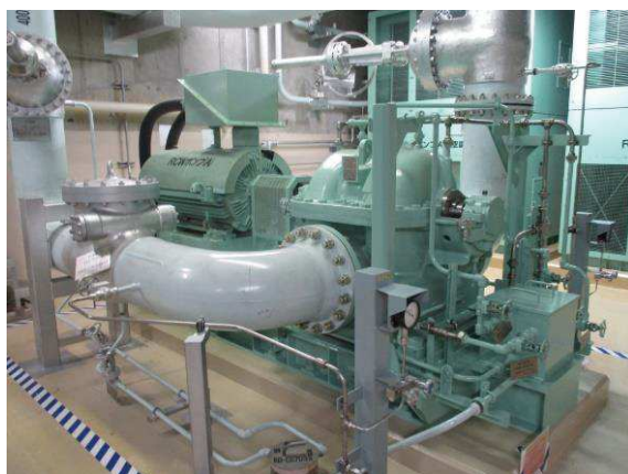
原子炉補機冷却水系ポンプ
