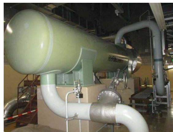
残留熱除去系熱交換器
