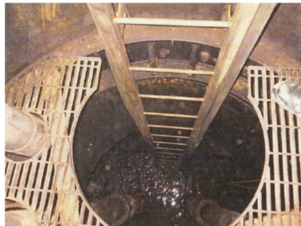
写真C 揚水井戸⑦（下段部） 2017/3/16撮影
