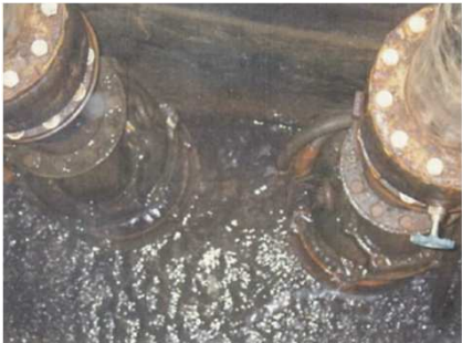
2号炉揚水ポンプの例 (揚水井戸⑥)
