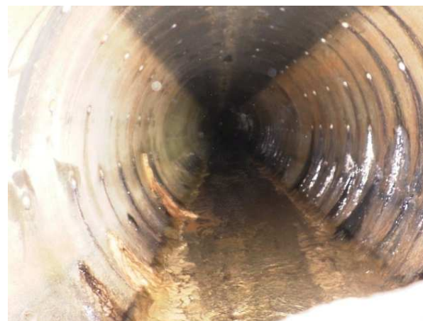
写真B ドレーン（有孔ヒューム管φ1,050mm） 2018/9/18撮影
