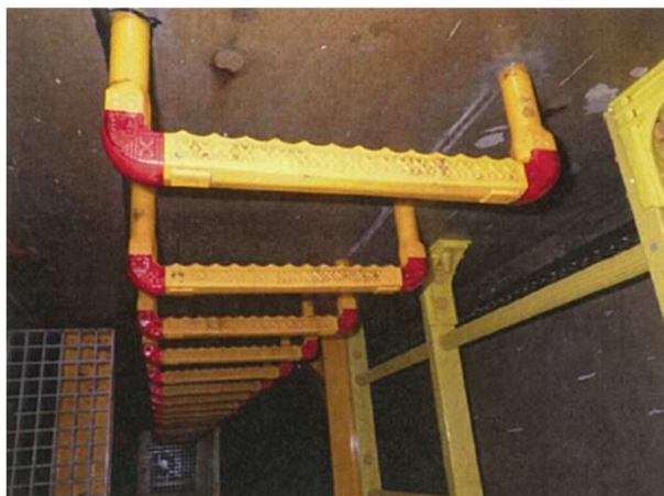
写真C 揚水井戸⑤（中段部） 2017/3/17撮影
