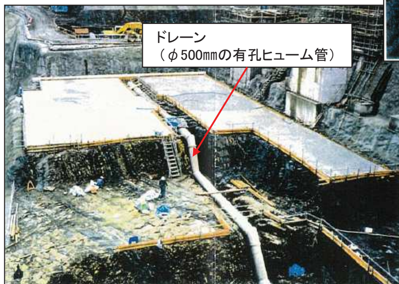
写真C 2号炉タービン建屋ドレーン ( \phi 500\text{mm} の有孔ヒューム管)
