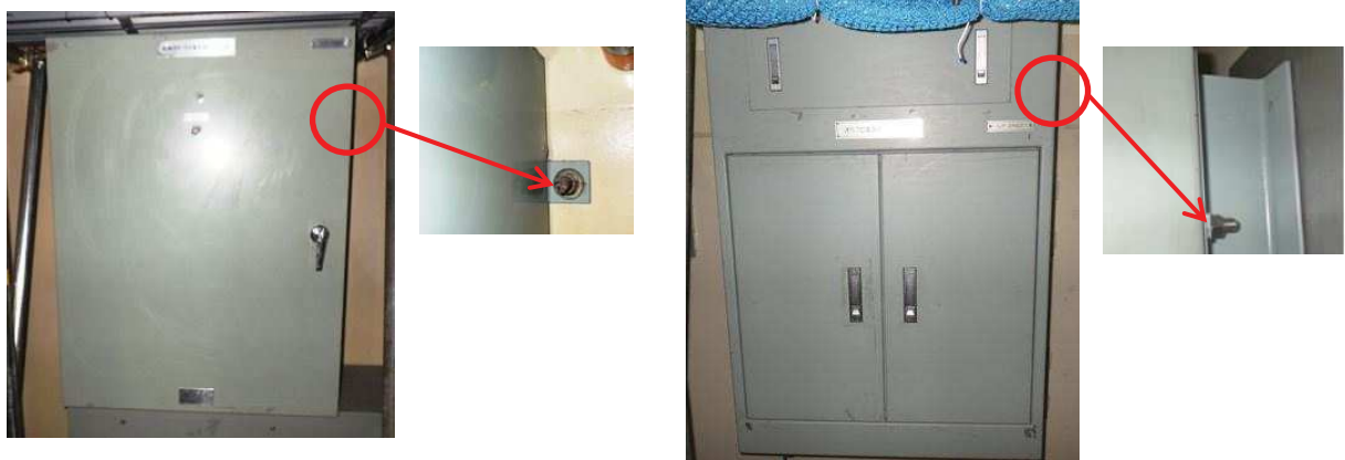
図2 電源盤のボルトによる壁面固定
