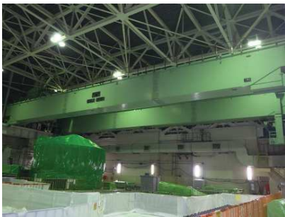
原子炉建屋クレーン
