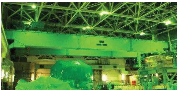
原子炉建屋クレーン外観
