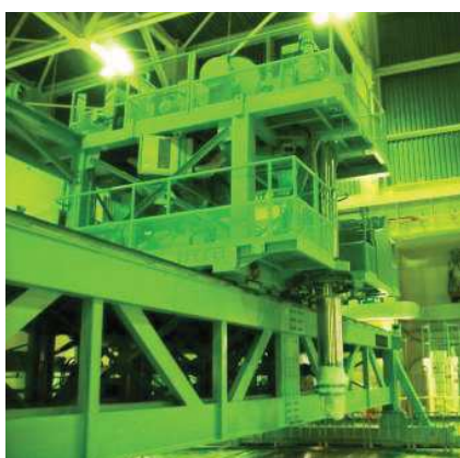
燃料交換機（トロリ）外観
