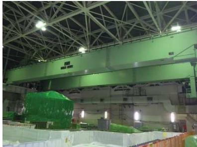
原子炉建屋クレーン
