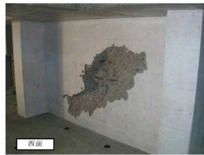
埋込金物破壊状況(シアコン破壊)
