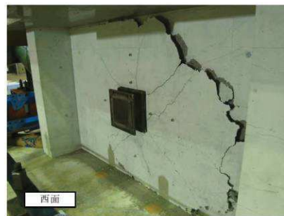
埋込金物破壊状況(シアコン破壊)
