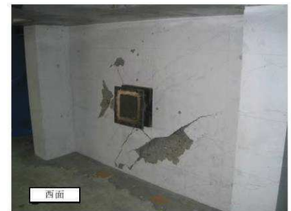
埋込金物破壊状況(シアコン破壊)
