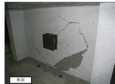
埋込金物破壊状況(シアコン破壊)
