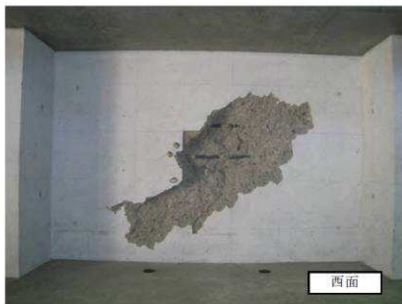
埋込金物破壊状況(シアコン破壊)
