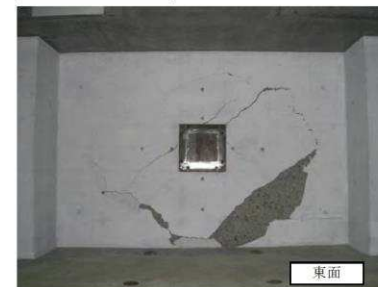
埋込金物破壊状況(シアコン破壊)
