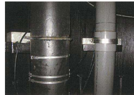
3号炉配管の例 (揚水井戸⑦)
