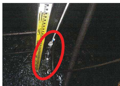
3号炉水位計の例 (揚水井戸⑦)
