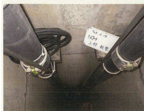
2号炉配管の例(揚水井戸④)
