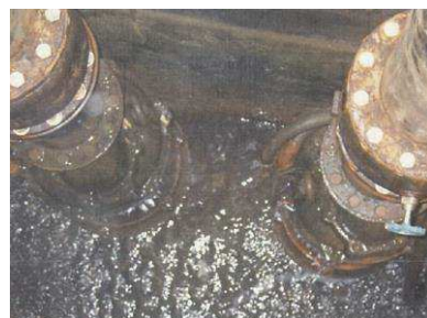
2号炉揚水ポンプの例 (揚水井戸⑥)
