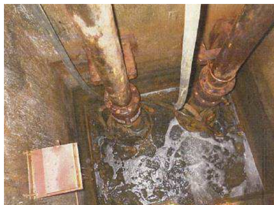
写真D 揚水井戸⑤（下段部） 2017/3/17撮影
