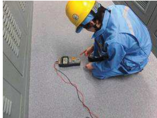
電池容量確認
