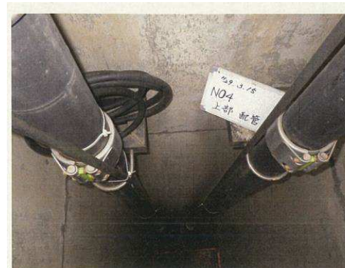
排水配管の例(井戸①)
