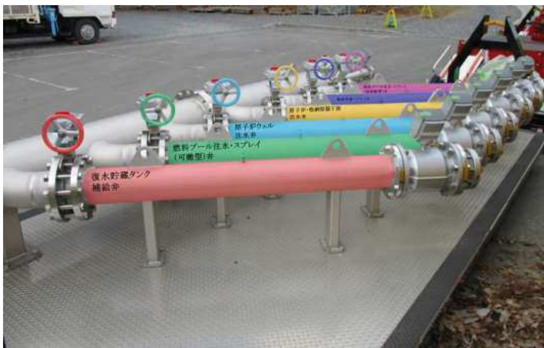
図 50-12-3 注水用ヘッドの誤接続及び誤操作の防止対策イメージ図
