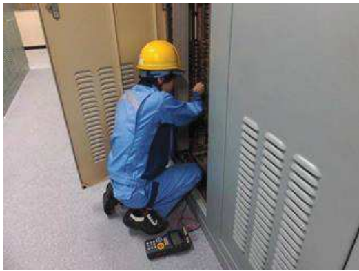
可搬型計測器接続
