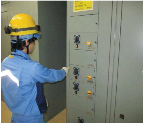
MCC 負荷の切離し操作
