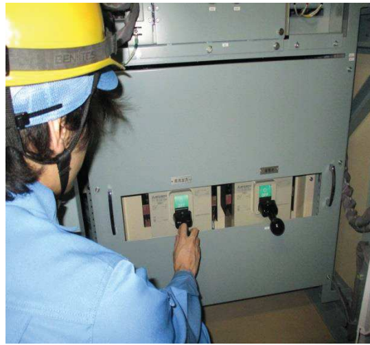
代替蓄電池の切操作
