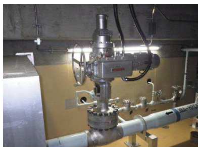
HPCS 注入隔離弁
