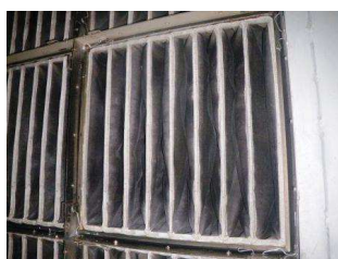
(バグフィルタ入口側)
