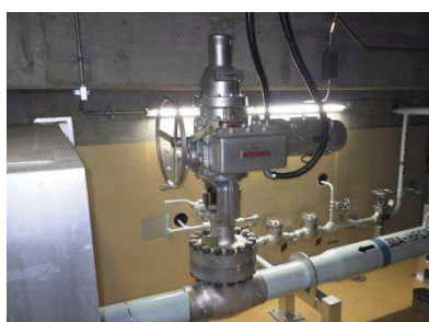
HPCS 注入隔離弁
