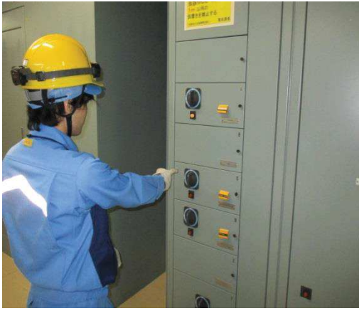
MCC 負荷の切離し操作
