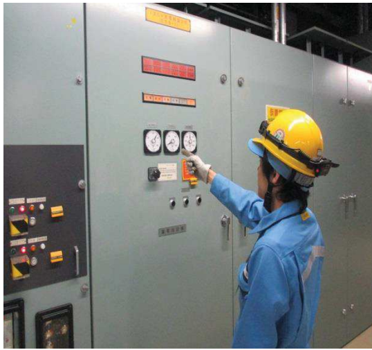
125V 代替充電器盤の受電状態確認
