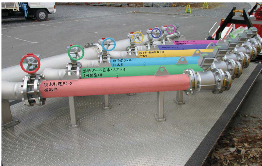
図 49-11-3 注水用ヘッドの誤接続及び誤操作の防止対策イメージ図
