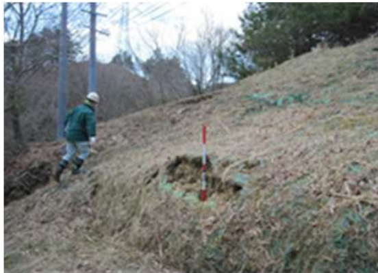
被害箇所① 肌落ちの状況
