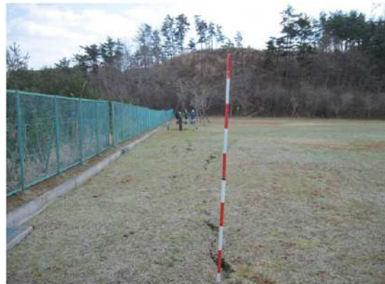
被害箇所② 法肩部の亀裂の状況
