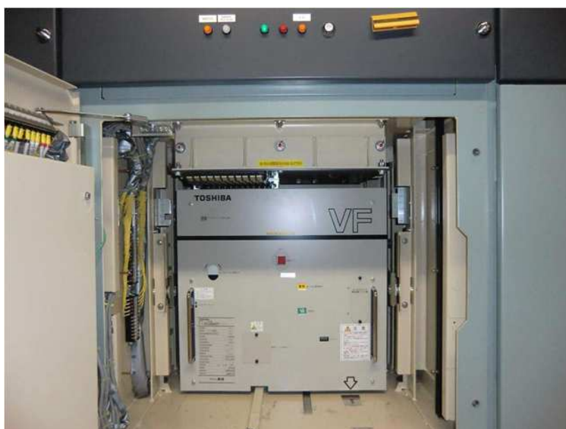
【対策後 VCB 遮断器】
