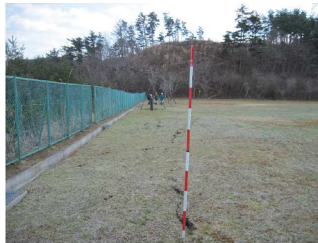
② 法肩部の亀裂の状況
