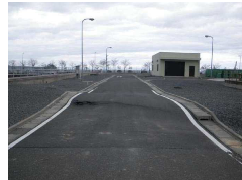
③ 段差発生状況
