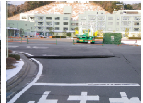
④ 段差発生状況
