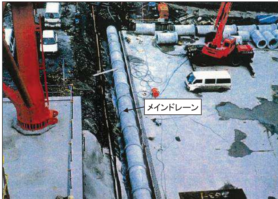
2号炉原子炉建屋北側 メインドレーン φ1,050有孔ヒューム管(写真A)
