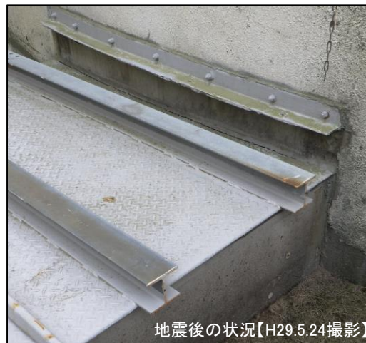
←1号炉SPTとT-11トレンチの接続部
