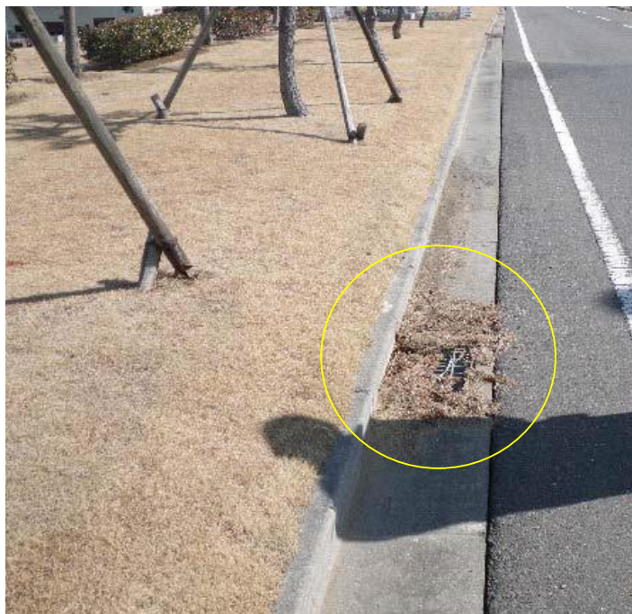
写真2 構内道路上に残留した塵芥
