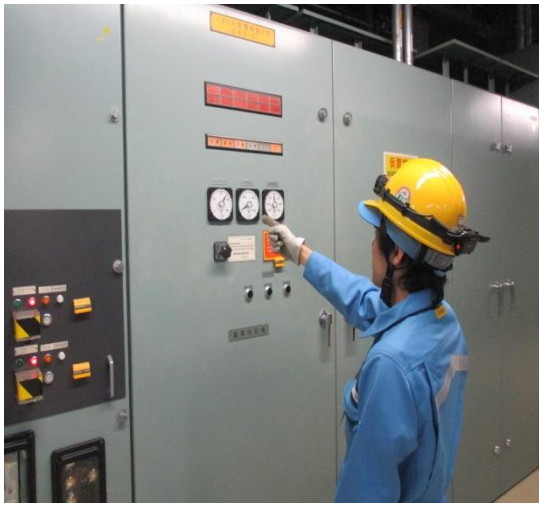
125V 代替充電器盤の受電状態確認
