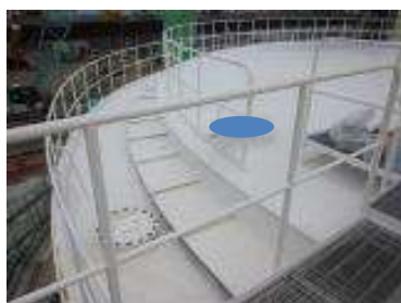
復水貯蔵タンク接続マンホール
