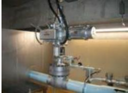
HPCS 注入隔離弁
