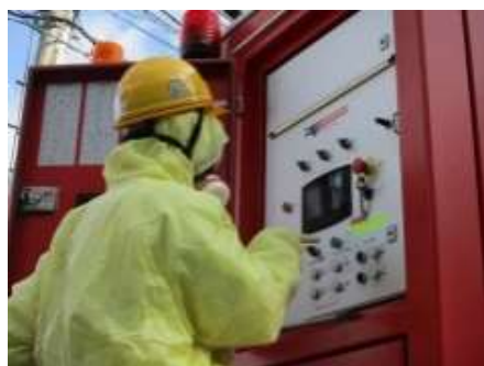
大容量送水ポンプ(タイプⅡ)の起動
