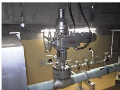
HPCS 注入隔離弁
