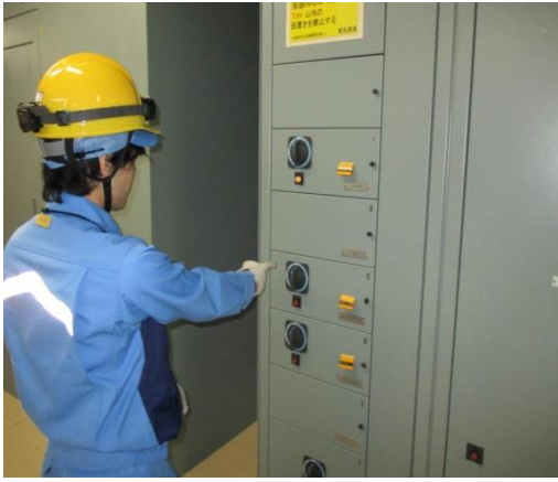
MCC 負荷の切離し操作
