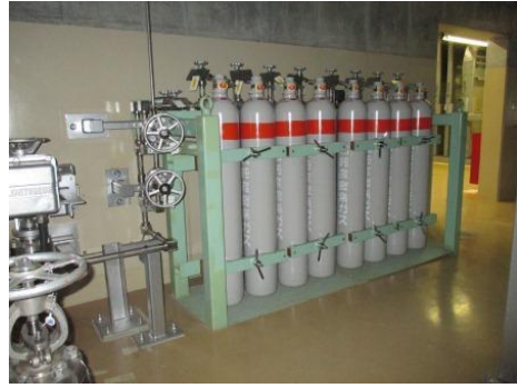
高圧窒素ガスボンベ
