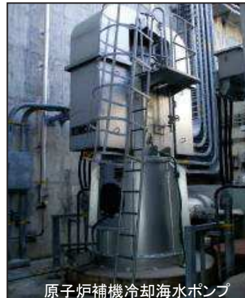
図7-4-1 非常用海水ポンプの状況
