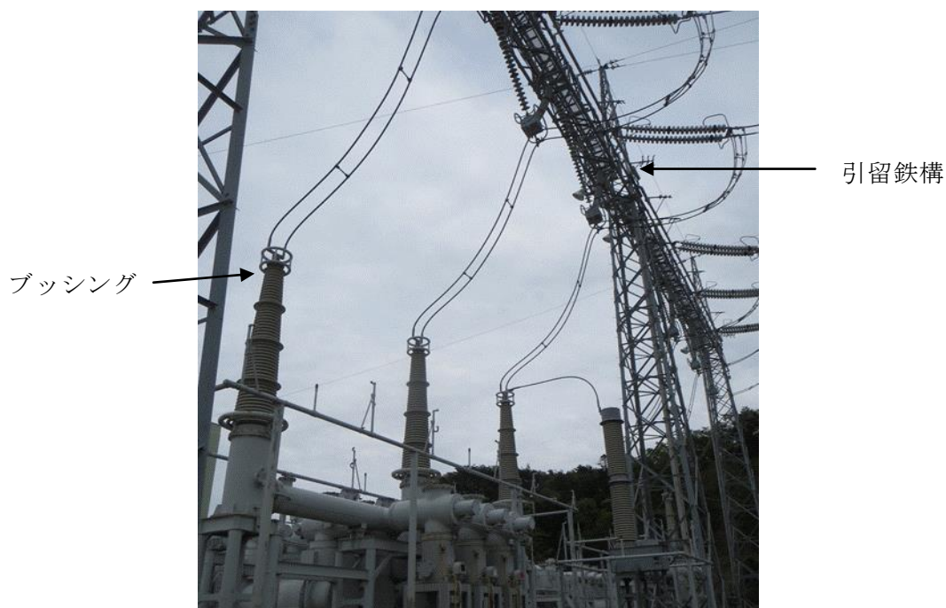
第 2.2.1-9 図 送電線引込み部（275kV 開閉所の例）
