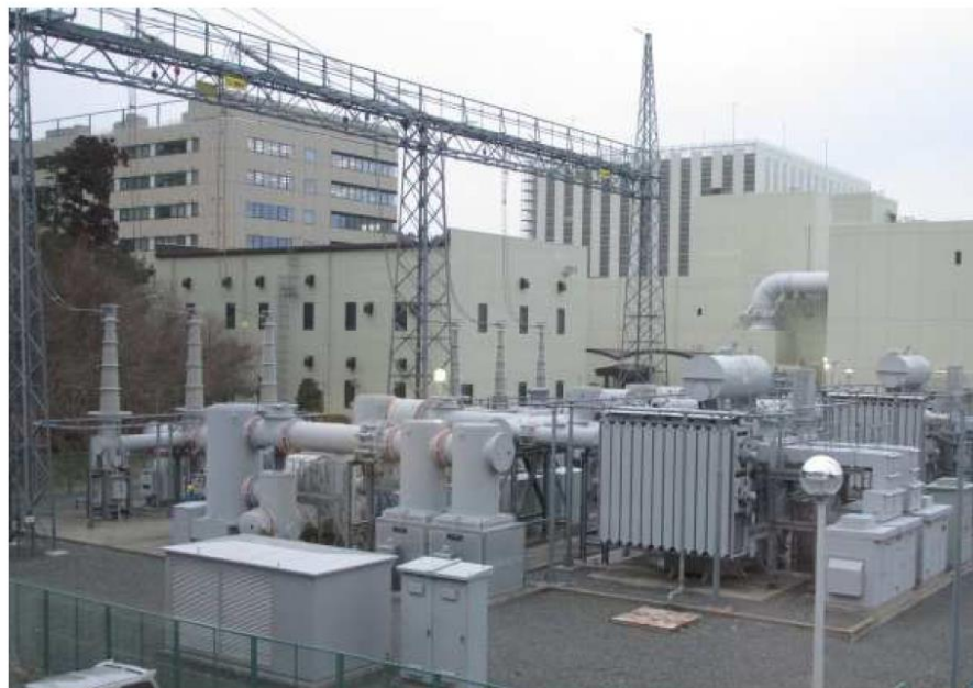
第 2.1.4-6 図 開閉所設備外観
