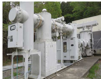
予備変圧器1次側
