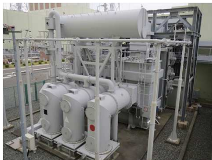
起動変圧器1次側
