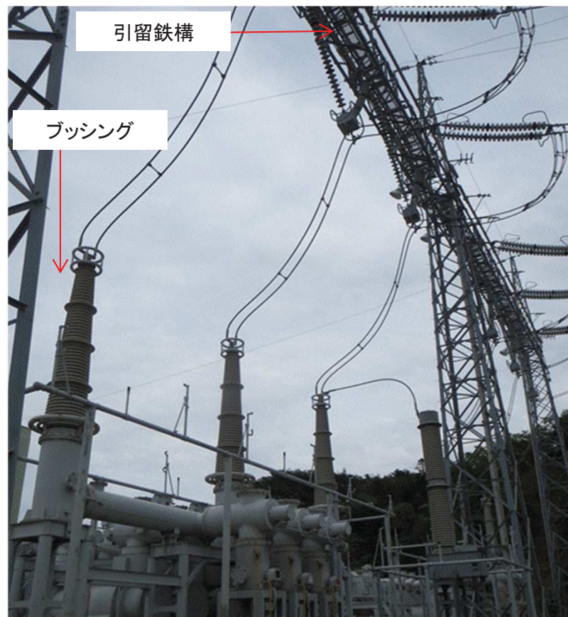
送電線引込み部 (275kV開閉所の例)
