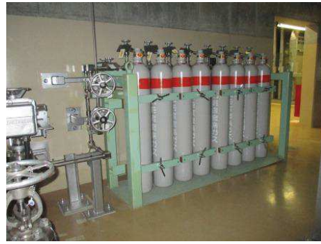
高圧窒素ガスボンベ
