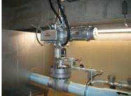
HPCS 注入隔離弁
