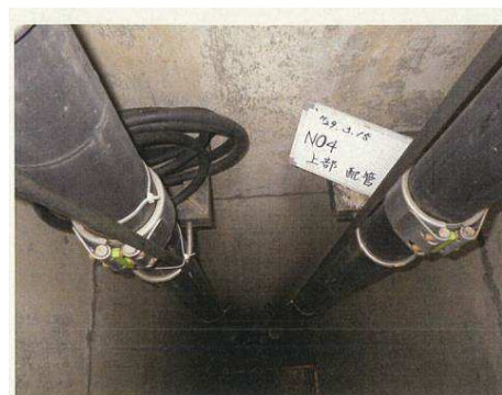
排水配管の例(井戸①)
