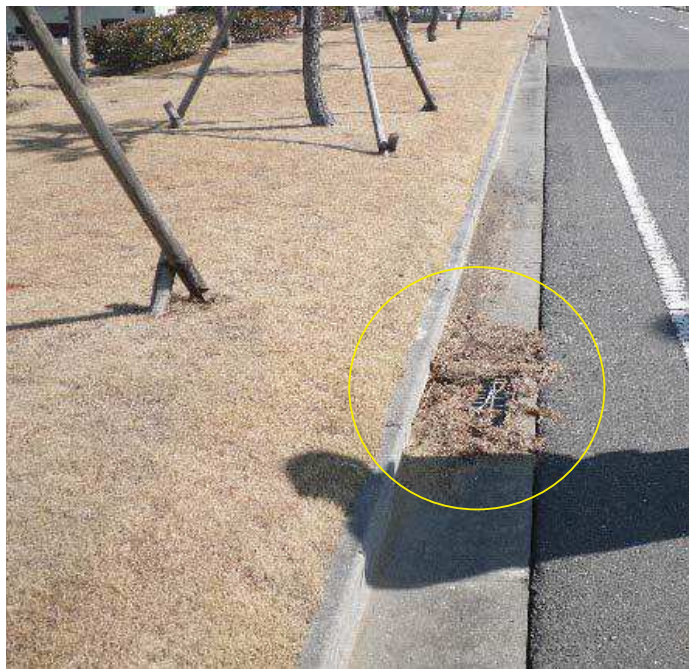
写真2 構内道路上に残留した塵芥
