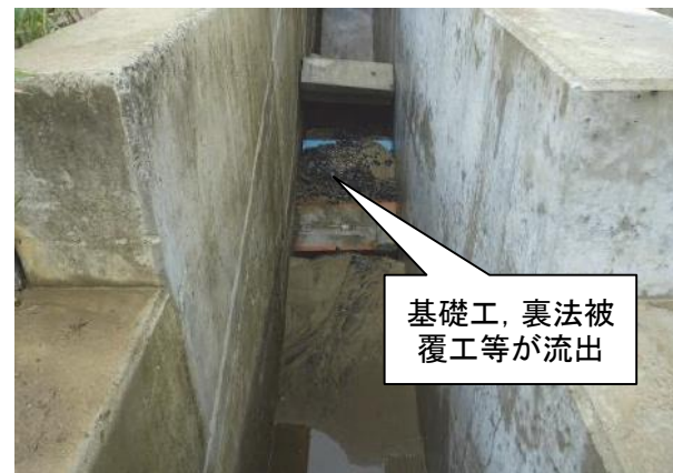
◆ ケース5-1-2m(地盤改良なし)の試験終了後状況
