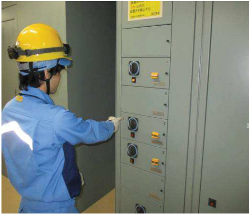
MCC 負荷の切離し操作
