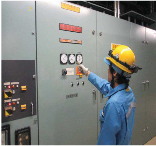
125V 代替充電器盤の受電状態確認
