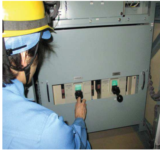
代替蓄電池の切操作
