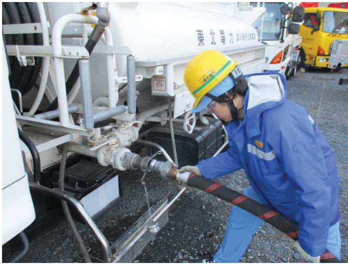
タンクローリへのホース接続
