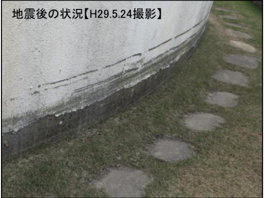
地震後の状況【H29.5.24撮影】
