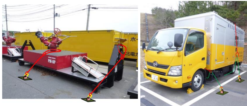
図 7-3 可搬型SA設備の飛散防止対策(例)※
