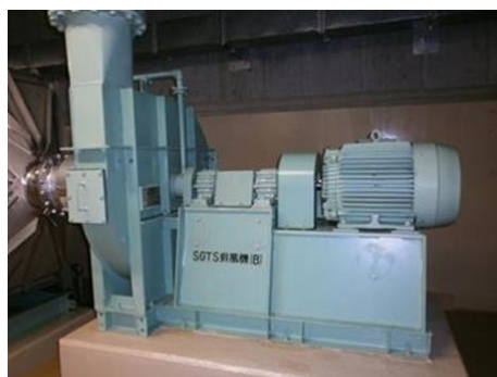
非常用ガス処理系排風機
