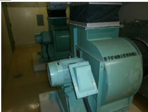
排風機及び可とう電線管
