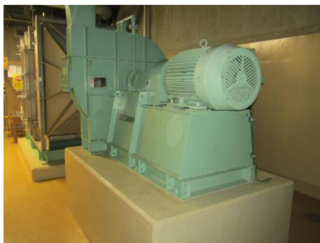
非常用ガス処理系排風機
