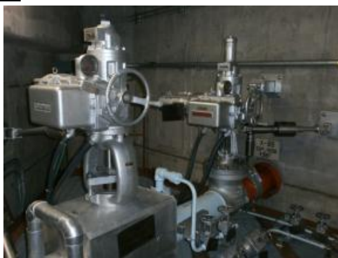
電動弁及び可とう電線管
