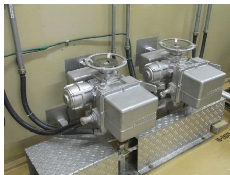
電動弁及び可とう電線管
