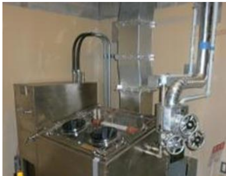
除染シンク及び可とう電線管
