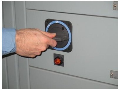
遮断器「切」操作
