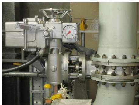
電動弁及び可とう電線管
