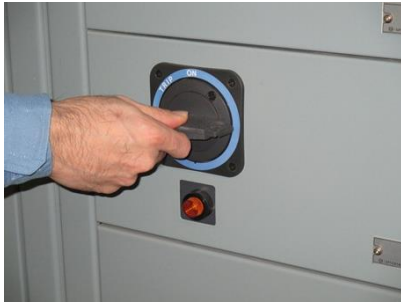
遮断器「切」操作
