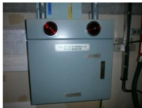
揚重機電源表示箱
