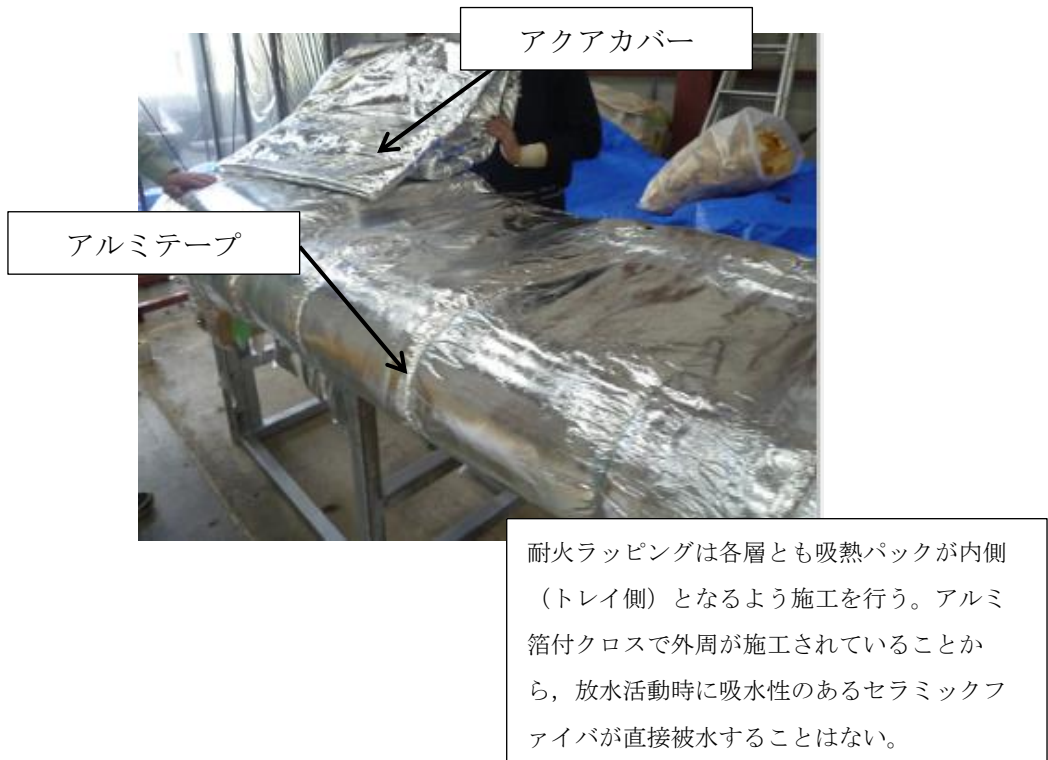
第 23 図 耐火ラッピング施工途中のケーブルトレイの外観写真
