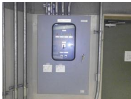
ハッチ開閉装置制御盤
