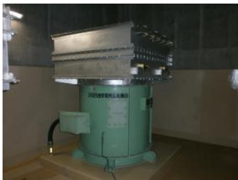
非常用送風機及び可とう電線管
