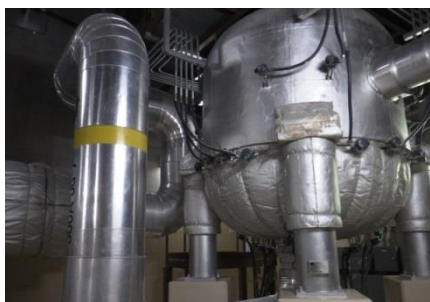
排ガス再結合器
