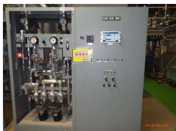
格納容器露点計ラック
