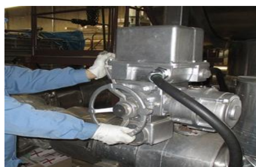
現場による電動弁の手動操作例
