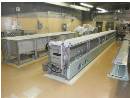
CRD 補修設備
