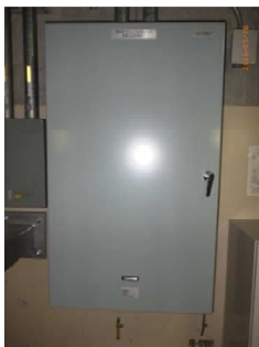
常用系プロセス放射線モニタ 多重伝送現場盤
