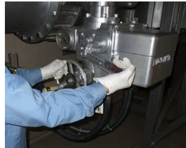
現場手動ハンドルによる開操作
