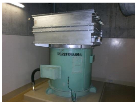
非常用送風機及び可とう電線管
