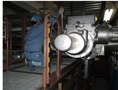
現場手動ハンドルによる開操作
