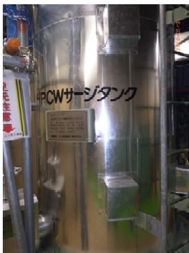
HPCW サージタンク
