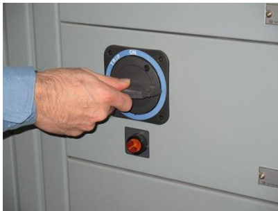
遮断器「切」操作
