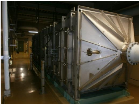
SGTS フィルタユニット
