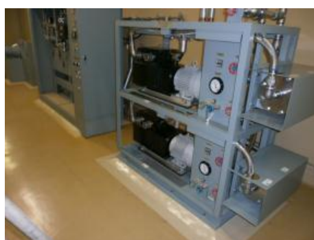
ポンプ及び可とう電線管
