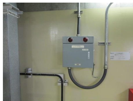
揚重機電源表示箱，電線管及び可とう電線管
