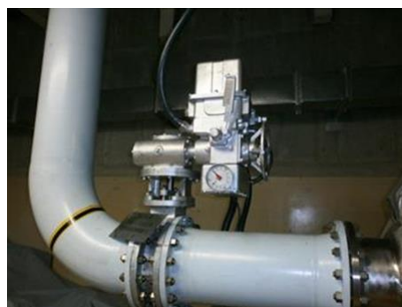
電動弁及び可とう電線管
