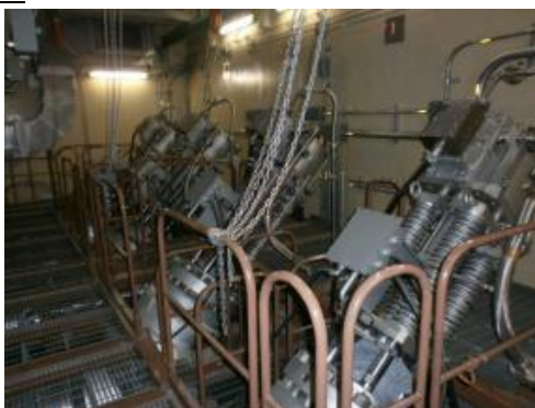
主蒸気第二隔離弁
