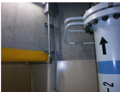
配管及び電線管
