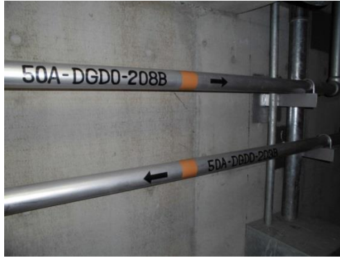
配管及び電線管
