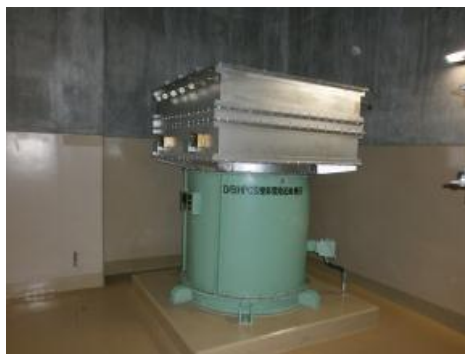
非常用送風機及び可とう電線管
