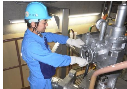
現場手動ハンドルによる閉操作
