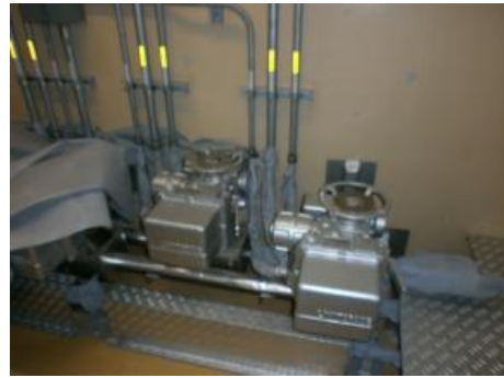
電動弁及び電線管
