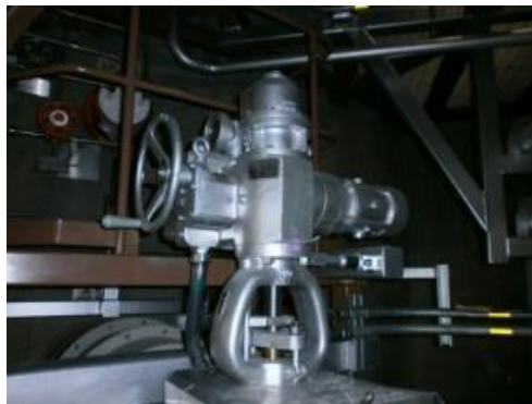
電動弁及び可とう電線管
