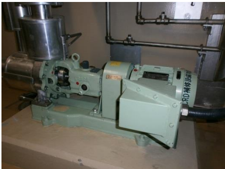
ポンプ及び可とう電線管
