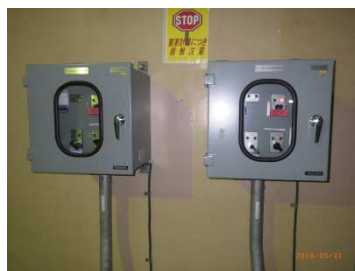
ほう酸水注入系現場操作箱
