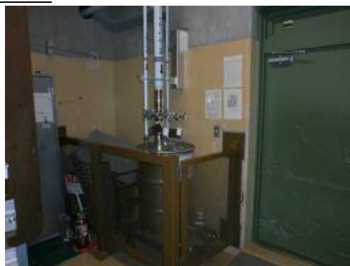
SLC ドレン受けタンク
