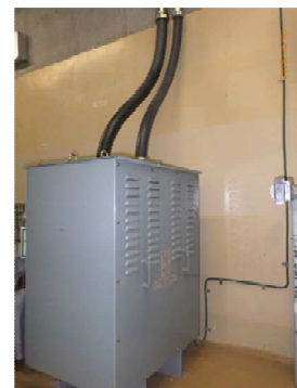
オペフロ電源 ボックス用変圧器
