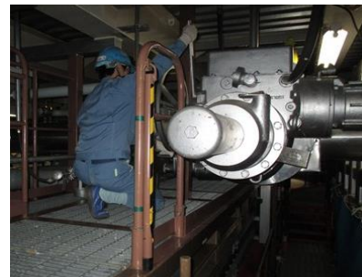
現場手動ハンドルによる開操作
