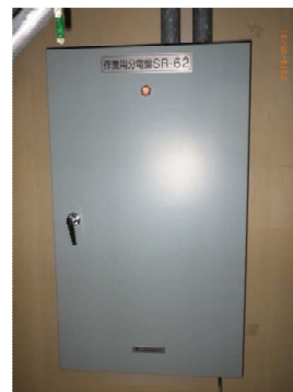
作業用分電盤
