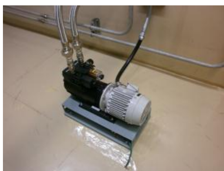
ポンプ及び可とう電線管
