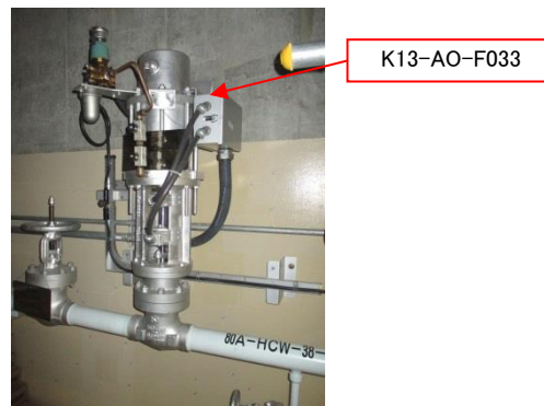
HCW放水路移送ライン (2号炉側) の弁配置 (南側通路)
