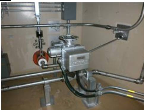
電動弁及び可とう電線管
