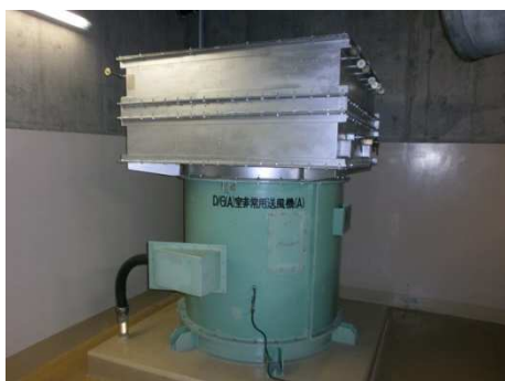
D/G(A)室非常用送風機室
