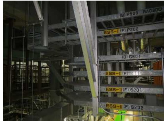
ケーブルトレイ，電線管の例
