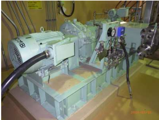
ポンプ，配管，支持構造物の例
