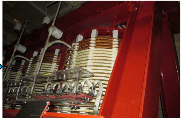
動力変圧器（パワーセンタ） 種類：乾式変圧器
