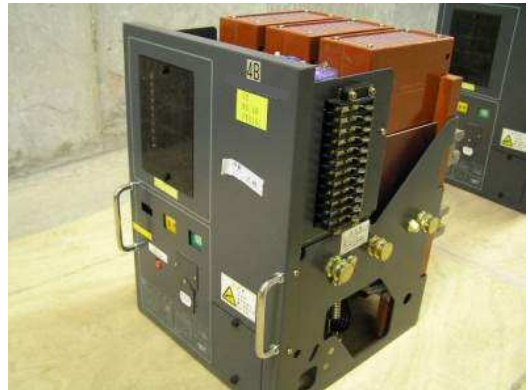
パワーセンタ 種類：気中遮断器
