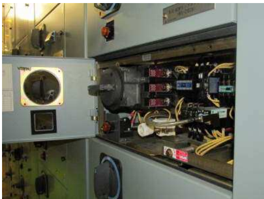
モータコントロールセンタ 種類：気中遮断器
