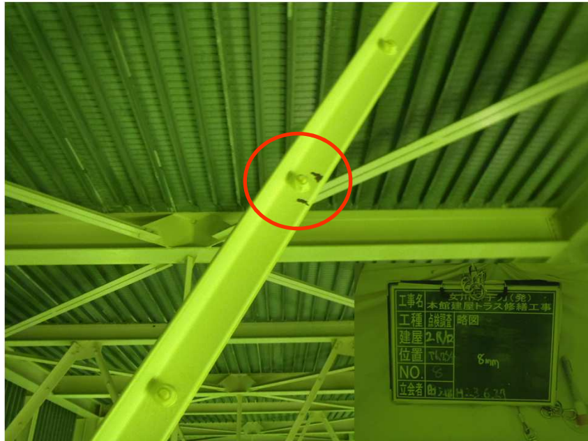
サブトラス(構造部材) 斜材 8mm変形
