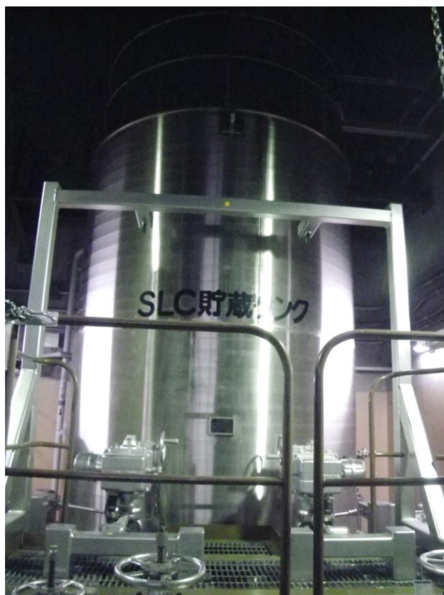
(a) ほう酸水注入系貯蔵タンク
