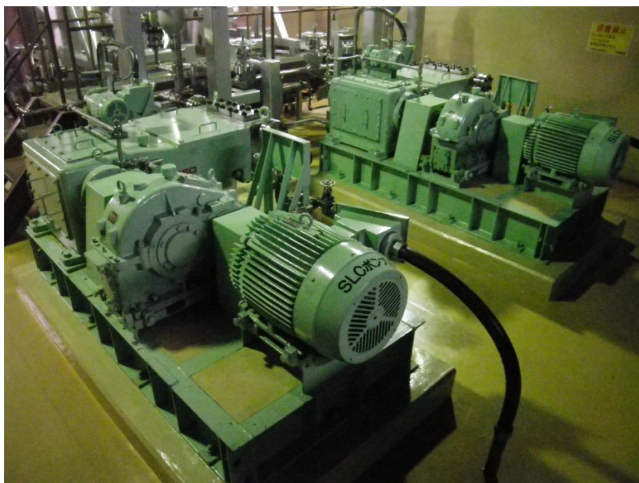
(b) ほう酸水注入系ポンプ
