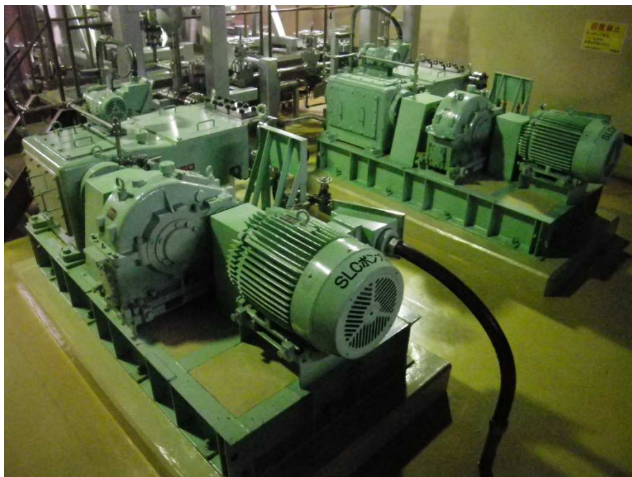
(b) ほう酸水注入系ポンプ
