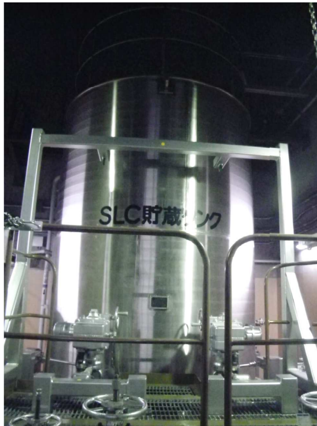
(a) ほう酸水注入系貯蔵タンク
