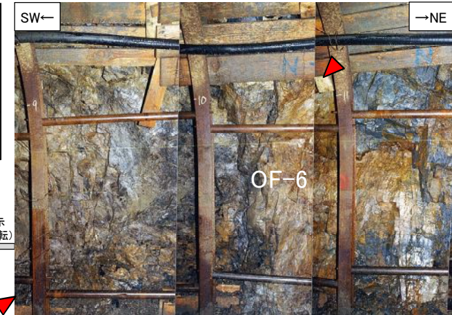
3号炉試掘坑2坑北西壁で確認したOF-6断層(右:写真, 左上:スケッチ)
