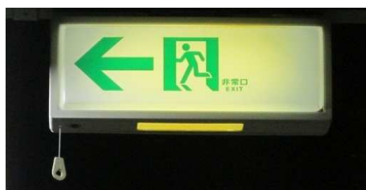
(b) 通路誘導灯
