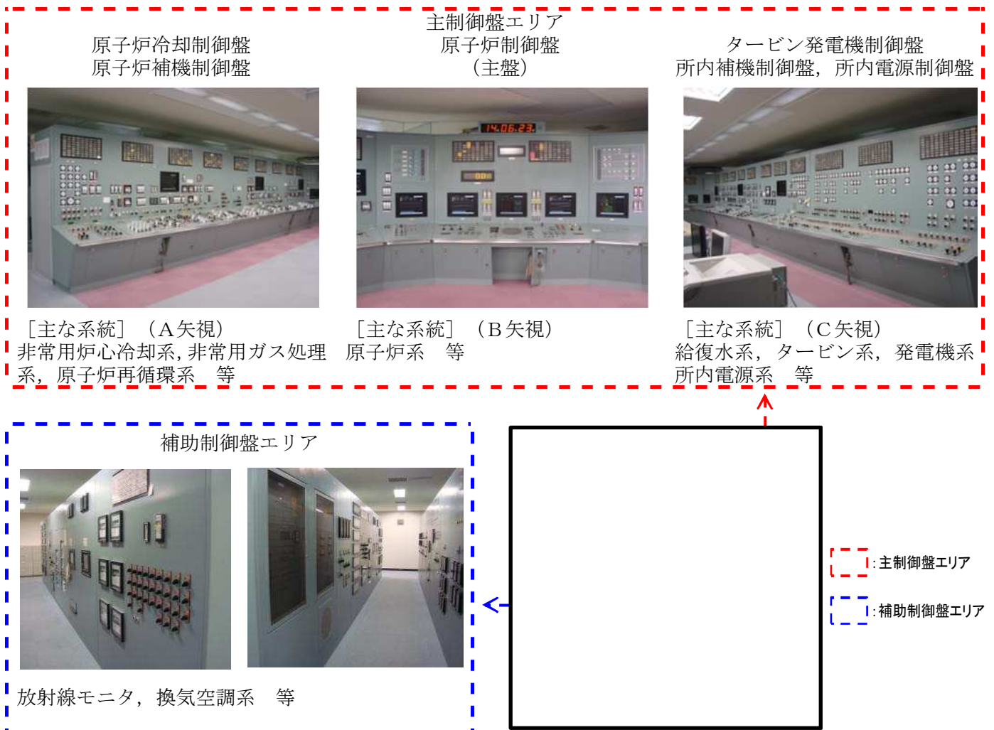
図2 主制御盤及び補助制御盤エリア
