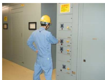
直流電源負荷切り離し (125V直流主母線盤)
