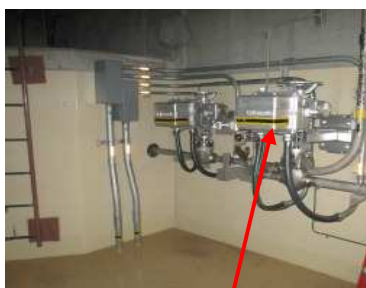
HPIN 常用非常用窒素ガス連絡弁
