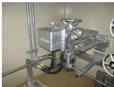
高圧窒素ガス供給元弁
