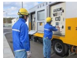
⑧電源車起動
