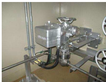
高圧窒素ガス供給元弁
