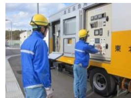
⑧電源車起動
