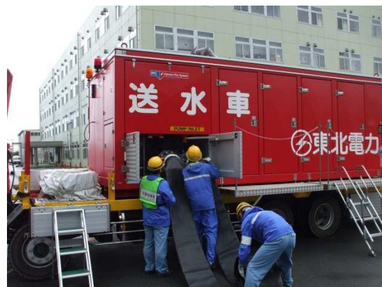
取水用ホースの接続
