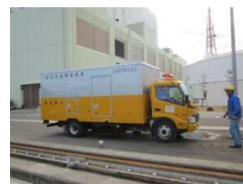
④電源車現場配置
