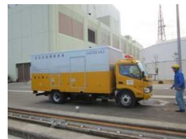
④電源車現場配置
