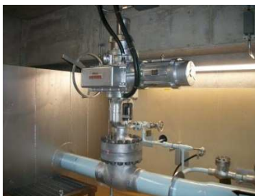
HPCS 注入隔離弁
