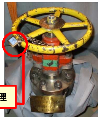
原子炉再循環ポンプ (B) 入口管第一ドレン弁 (B32-F503BX)
