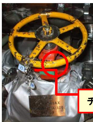
原子炉再循環ポンプ (A) 入口管第一ドレン弁 (B32-F503AX)
