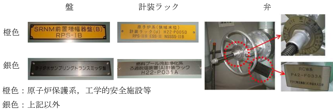
図1-8 銘板による識別管理（例）
