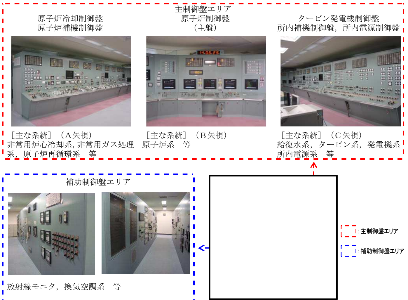
図2 主制御盤及び補助制御盤エリア
