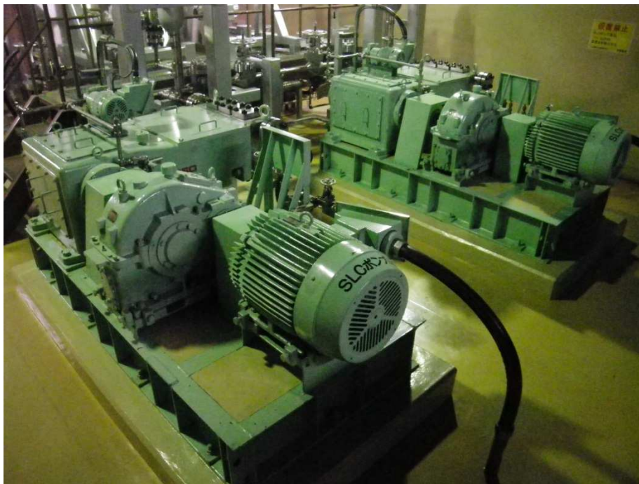
ほう酸水注入系ポンプ外観
