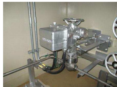
高圧窒素ガス供給元弁
