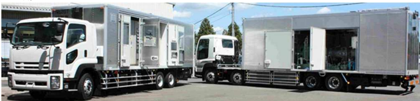
(同型ガスタービン発電機)
