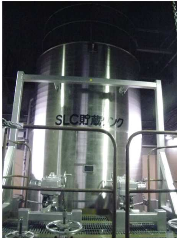
ほう酸水注入系貯蔵タンク外観
