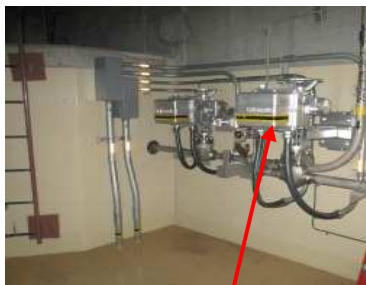
HPIN 常用非常用窒素ガス連絡弁
