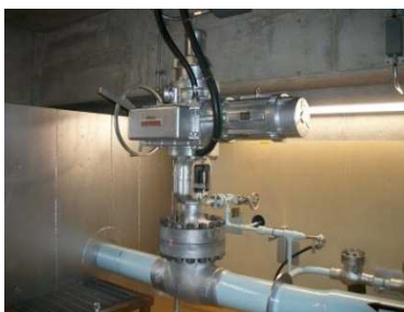
HPCS 注入隔離弁
