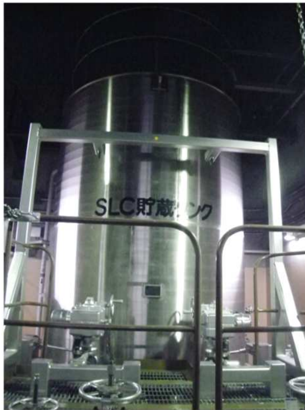
ほう酸水注入系貯蔵タンク外観
