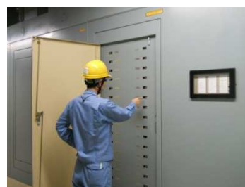
直流電源負荷切り離し (125V直流分電盤)
