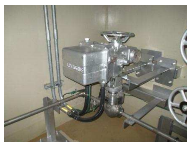
高圧窒素ガス供給元弁
