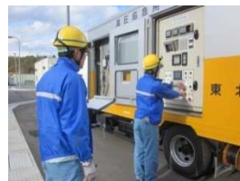
⑧電源車起動
