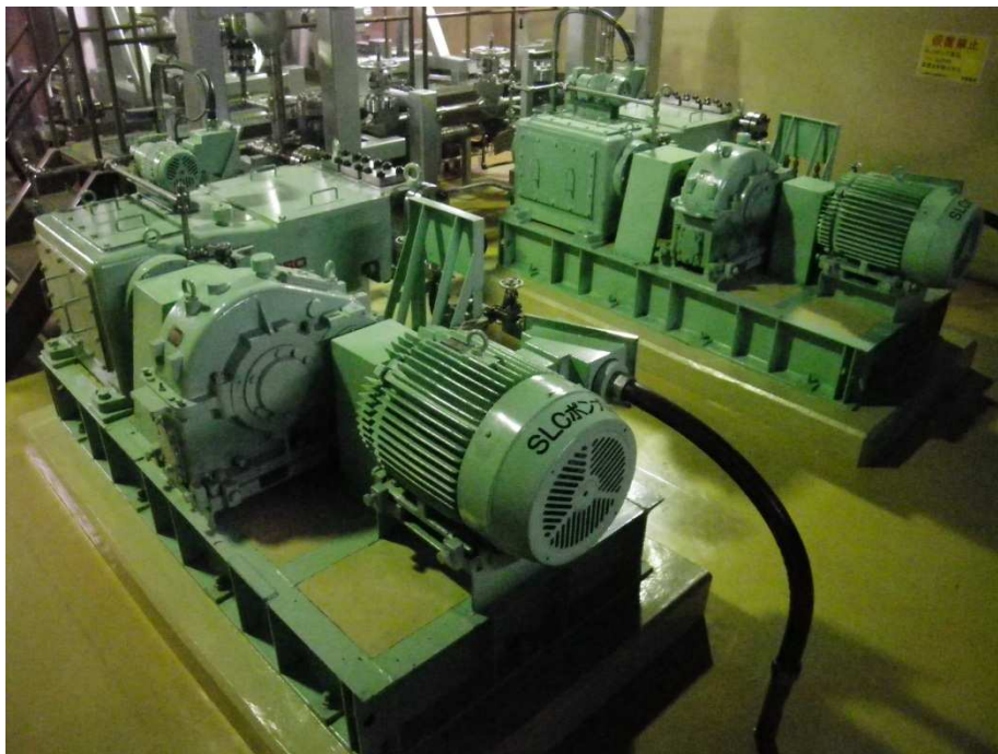
ほう酸水注入系ポンプ外観
